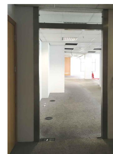
FOTO 1: VÃO COM ESTRUTURA EM AÇO EXISTENTE PARA INSTALAÇÃO DE PORTA EM VIDRO TEMPERADO NO 4º ANDAR.
