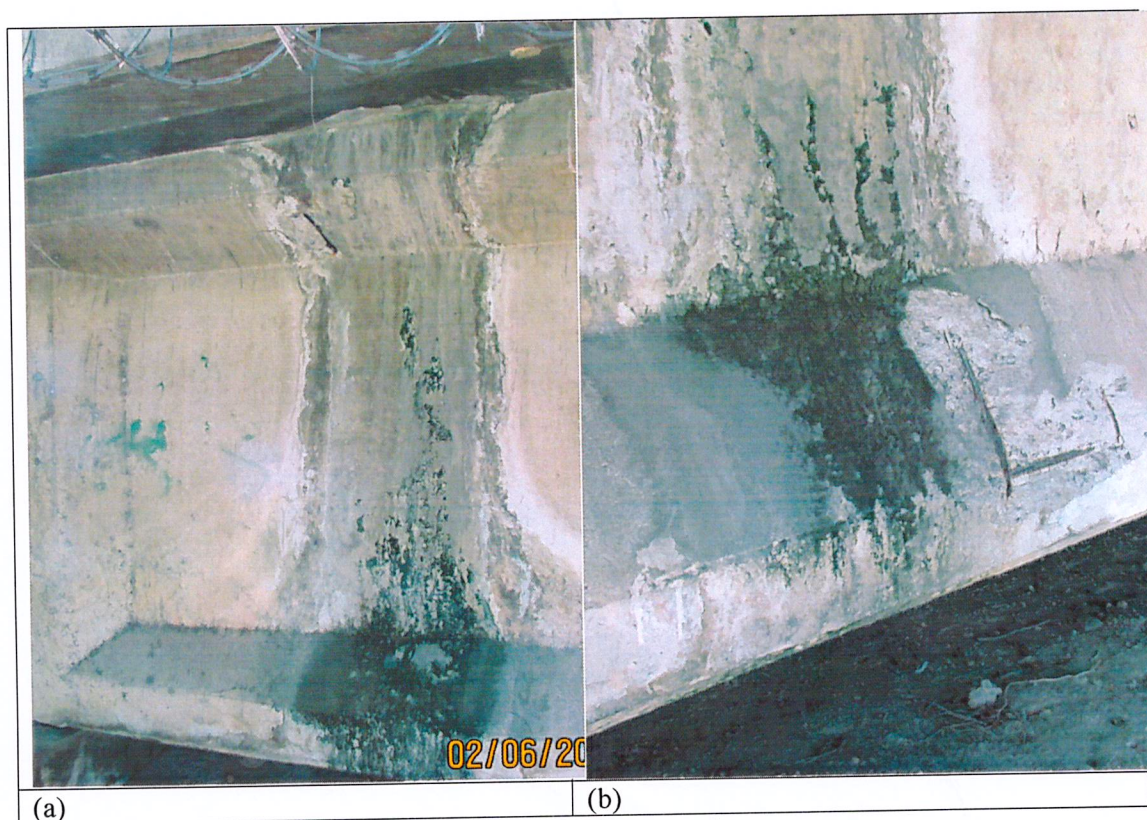
Figura 19: (a) e (b) eflorescência e armaduras expostas oxidadas;
