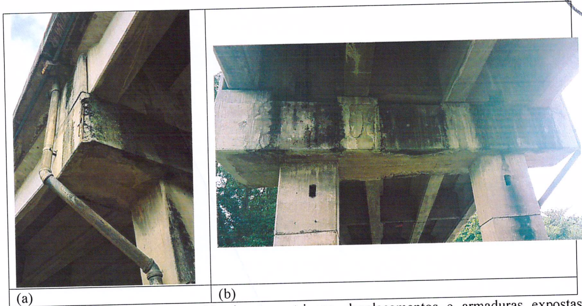
Figura 10: (a) quina quebrada, (b) viga com trincas, deslocamentos e armaduras expostas oxidadas, observa-se a ação biológica do limo;
