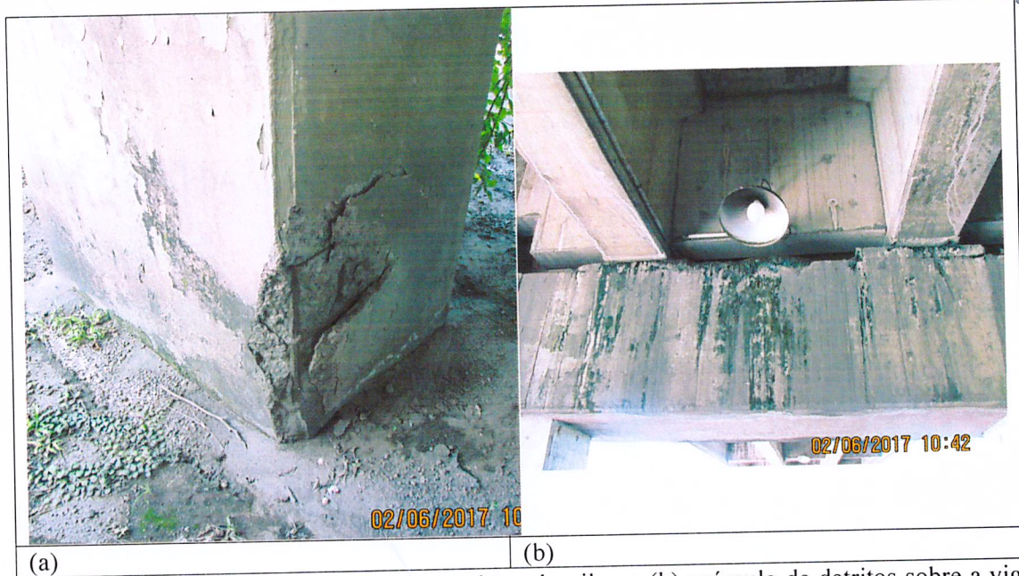
Figura 35: (a) trincas e armaduras exposta na base do pilar, e (b) acúmulo de detritos sobre a viga do pórtico;
