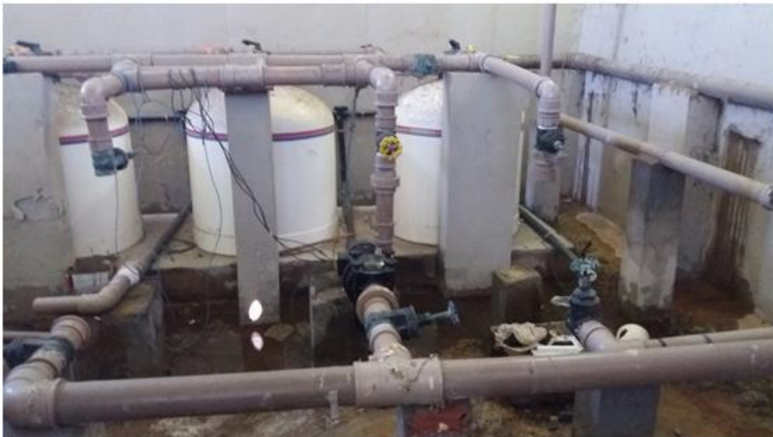
Instalações elétricas de bomba improvisada, com condutores soltos. Há risco de curto-circuito devido ao piso inundado e aos condutores soltos.
