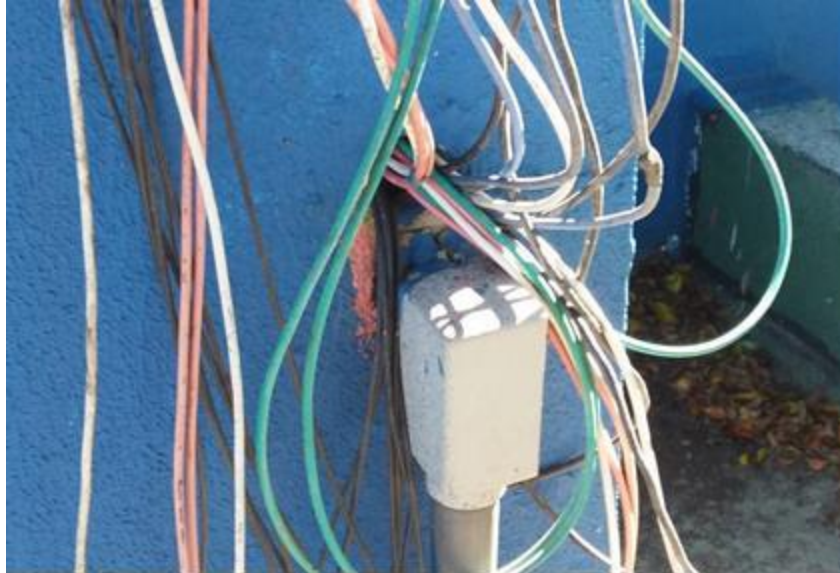
Cabeamento do sistema de ar condicionado solto e atravessando a alvenaria sem proteção mecânica
