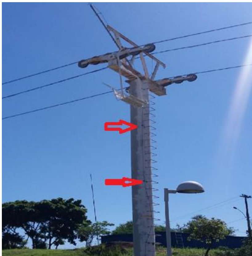
Isoladores do SPDA fixados à escada. Ao alcance das mãos dos passageiros
