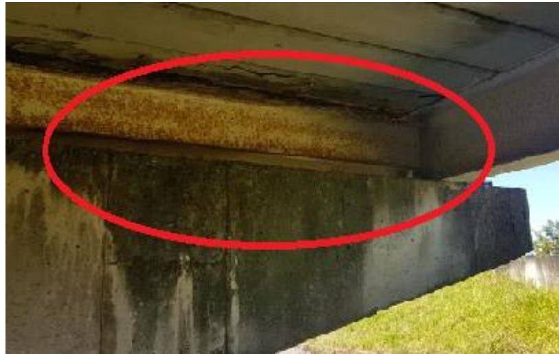
(v) vazamento na junta de dilatação entre os
