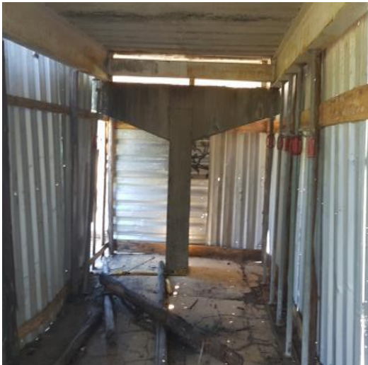
(iv) trecho do acidente cercado e escorado
