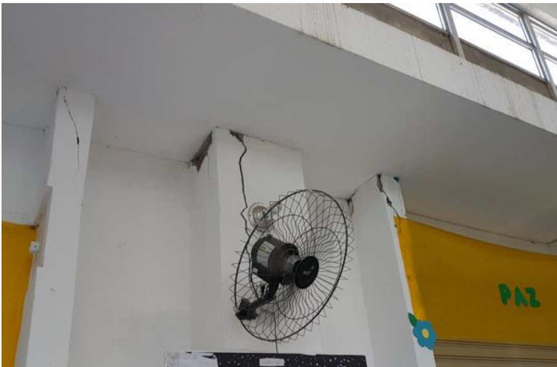
Ruptura da alvenaria em decorrência do deslocamento da laje superior
