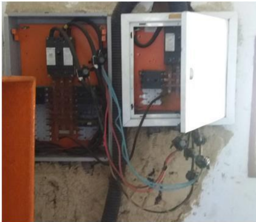
Quadros de distribuição sem barreiras que impeçam acesso a partes vivas e com condutores soltos.
