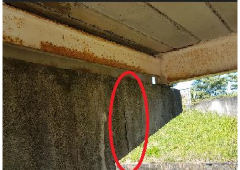
(ii) deslocamento do revestimento de concreto devido à corrosão do estribo (armadura de cisalhamento)
