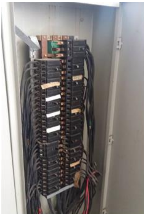
Disjuntores sem identificação
