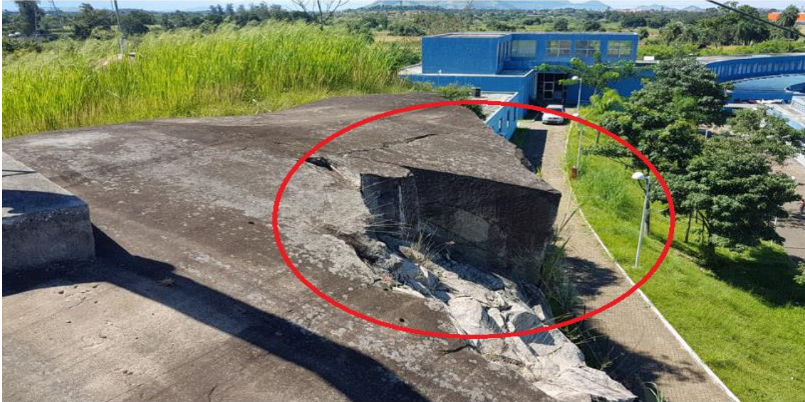
Trecho em rocha em processo de deslocamento
