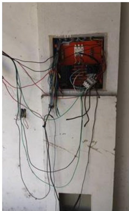
Disjuntor e condutores pendurados
