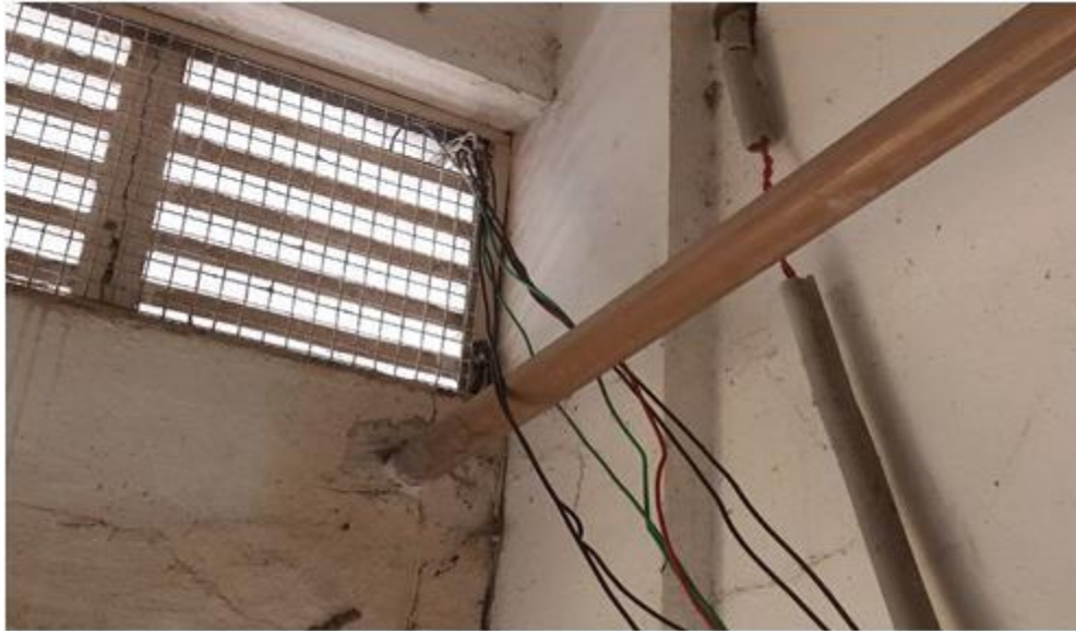
Condutores soltos passando através de grade metálica.
