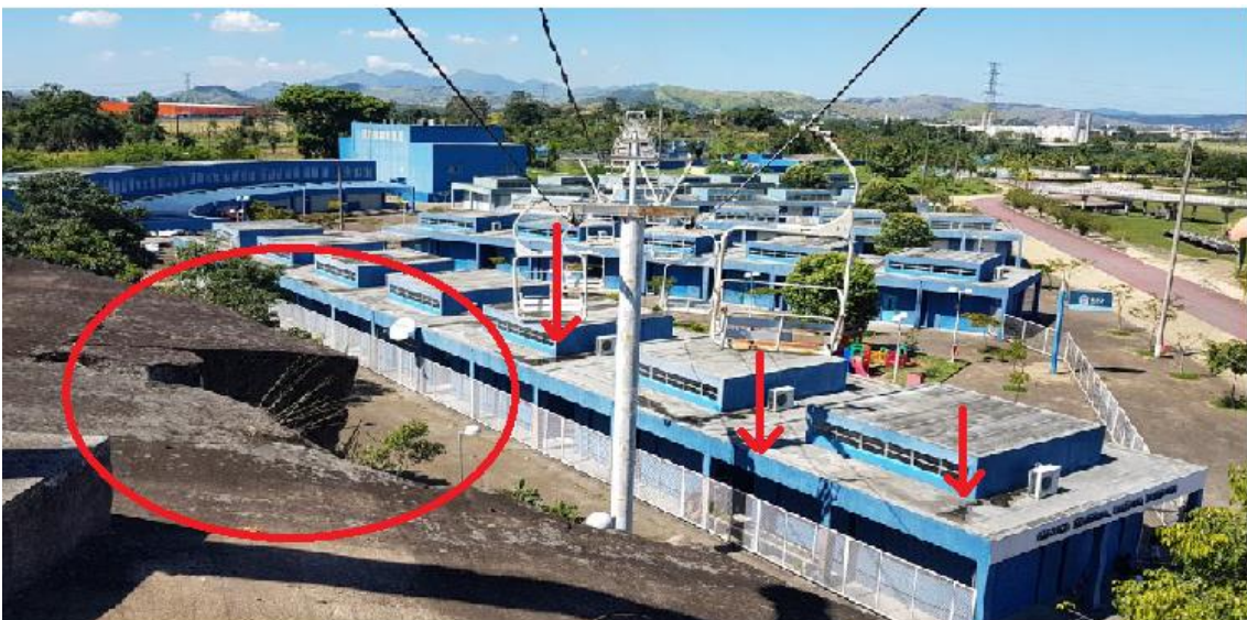
Vista superior da escola, com poças de água no telhado, geradas pelos aparelhos de ar condicionado, bem como rocha em processo de deslocamento
