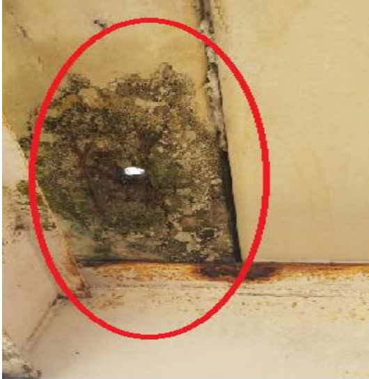
(i) laje danificada pela corrosão da armadura
