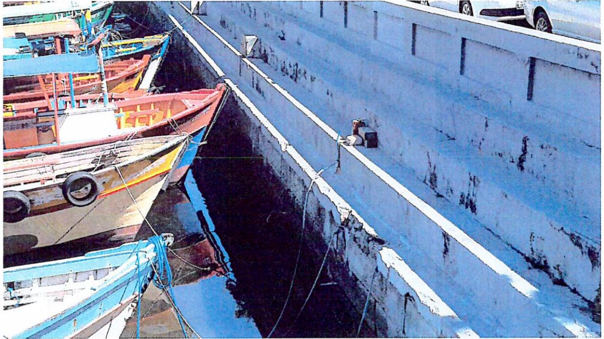
Tomadas improvisadas no lado interno da arquibancada.
