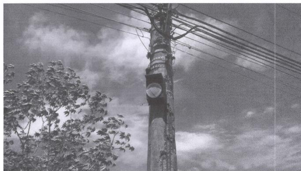
Foto 24 – Avenida da Areia Branca, próximo ao número, 1871, em frente ao Restaurante Bonsai
