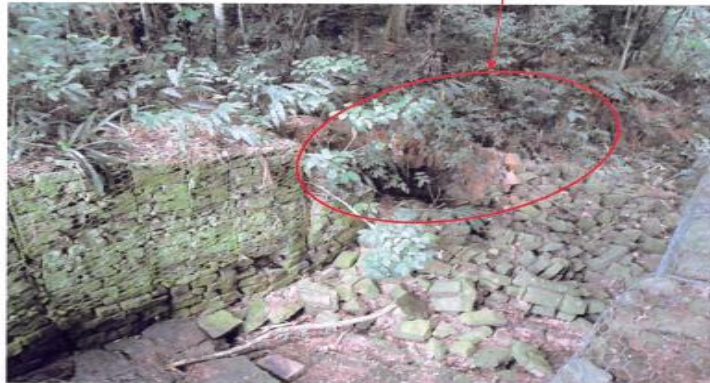
Parte do muro de gabiões que caiu
