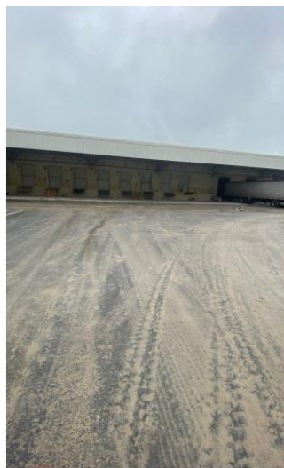
Espalhamento de material particulado no pátio do depósito dos produtos acabados.
