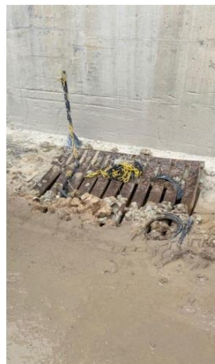
Drenagem da área de estocagem de resíduos, totalmente saturada.
