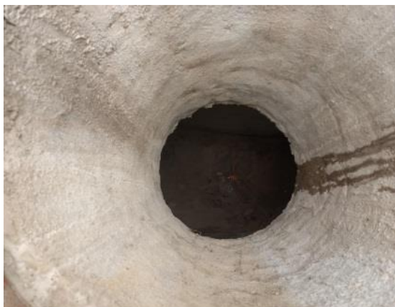
Caixa de passagem comprometida pelos sedimentos carreados.
