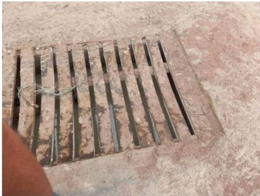
Caixa de passagem das águas pluviais, saturada por sedimentos.
