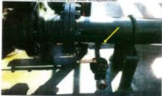
Figura 7. Destacando as duas abraçadeiras que teriam sido empregadas para reparar a tubulação danificada.
