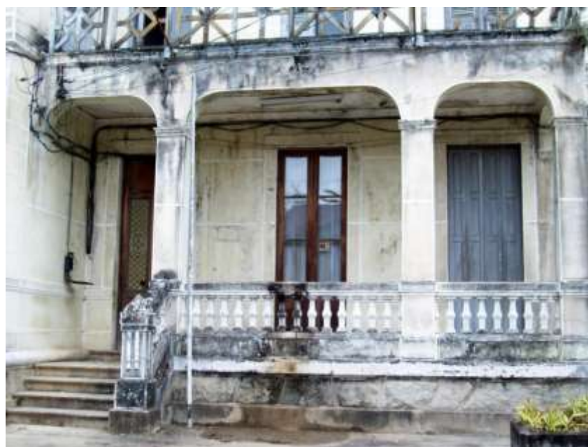
Figura 4: Estado de degradação do imóvel
