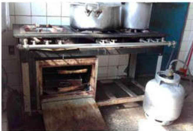
Em unidade municipal de Caxias, fogão visitado estava em péssimas condições - Divulgação
