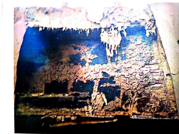
Figura 49: Elemento de madeira com vestígio de cupim.
