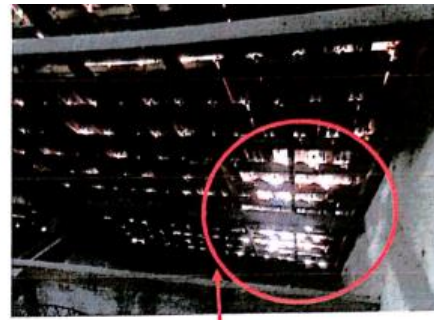
Telhas desalinhasadas e mal substituídas
