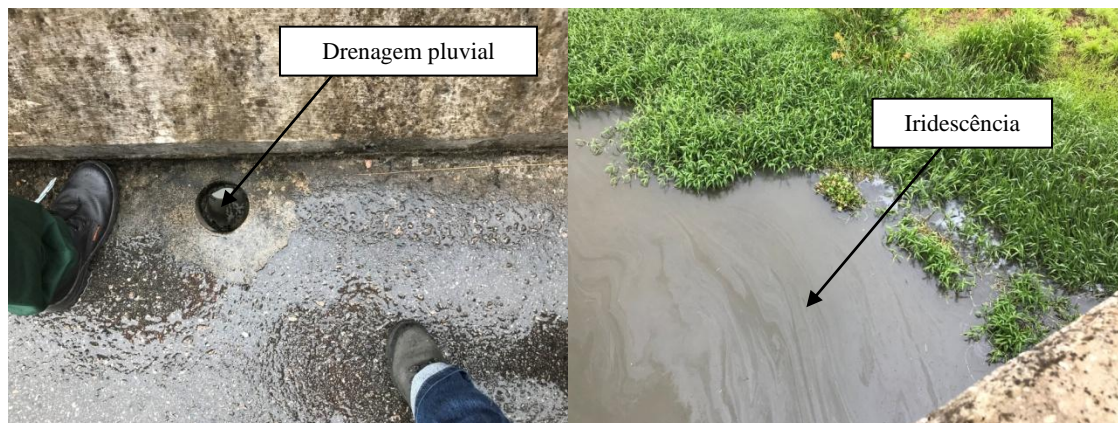
Figura 4: Drenagem na via de acesso, desprovida de qualquer dispositivo de segurança contracontaminação por produto de vazamento. Presença de iridescência no corpo hídrico interceptado pela via de acesso ao COMPERJ.
