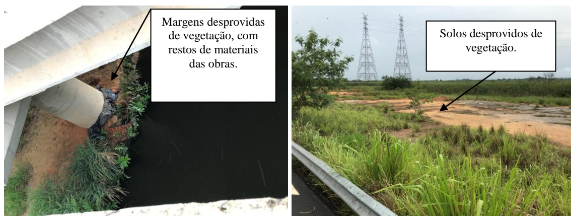
Figura 5: Margens desprovidas de vegetação, solo exposto, facilitando o processo de carreamento de partículas sólidas para o corpo receptor.
