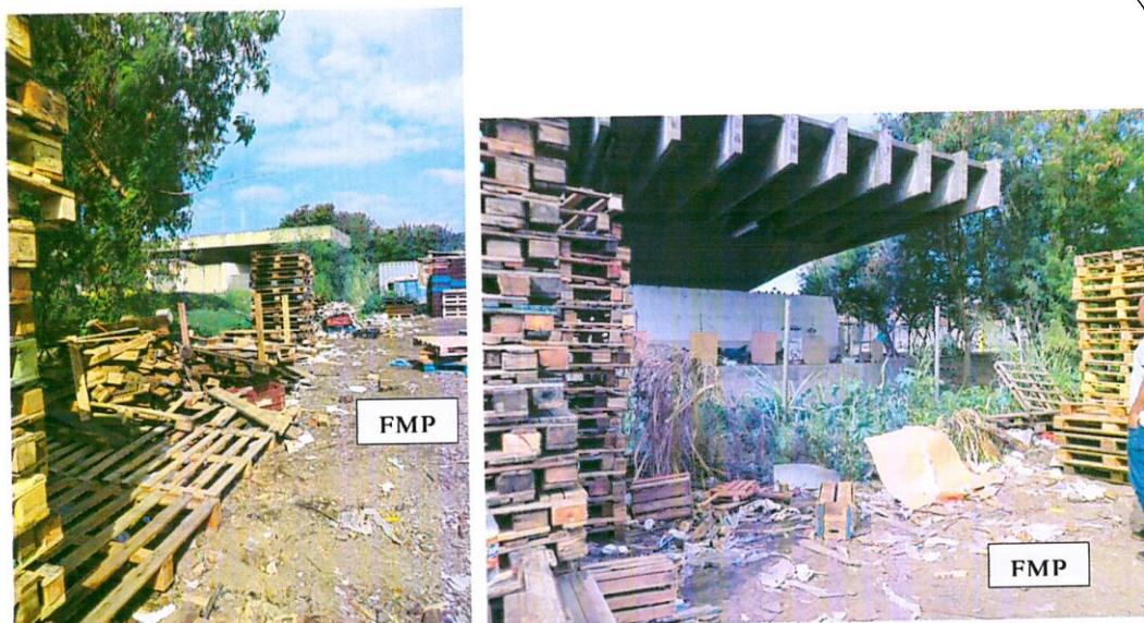
Figura 02: FMP do rio dos Cachorros, na altura da área projetada para uma Praça de Pedágio. Observa-se parte da tela danificada e parte dela já retirada.
