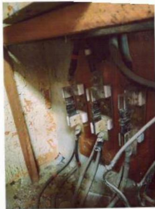
Figura 42: Bloco C, Ausência de fiação, há risco de sobrecarga
