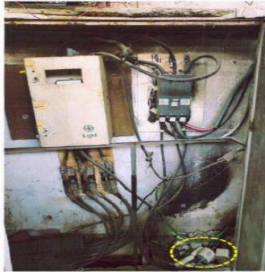
Figura 43: Bloco D, Ausência de fusíveis, há risco de sobrecarga. Evidências de incêndio progressivo e fusíveis, provavelmente inutilizados, retirados
