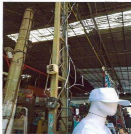
Figura 38: Bloco C, disjuntores fixados no pilar metálico com cabeamento entrelaçado com o mesmo
