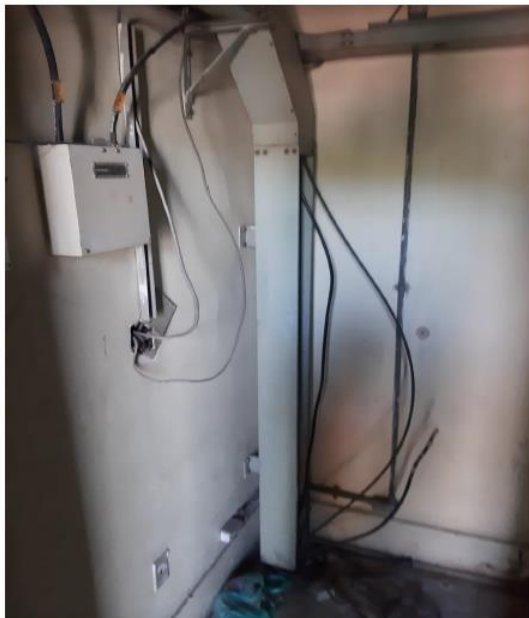
Foto 5 - Fiação exposta parte interna.
