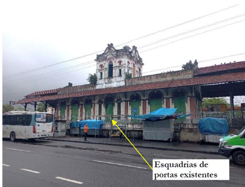
Figura 06 – Vista aproximada da fachada voltada para a Rua João Vicente, observando-se umidade descendente na platibanda frontal e vegetação crescente na cobertura. As esquadrias dos vãos das portas permanecem.
