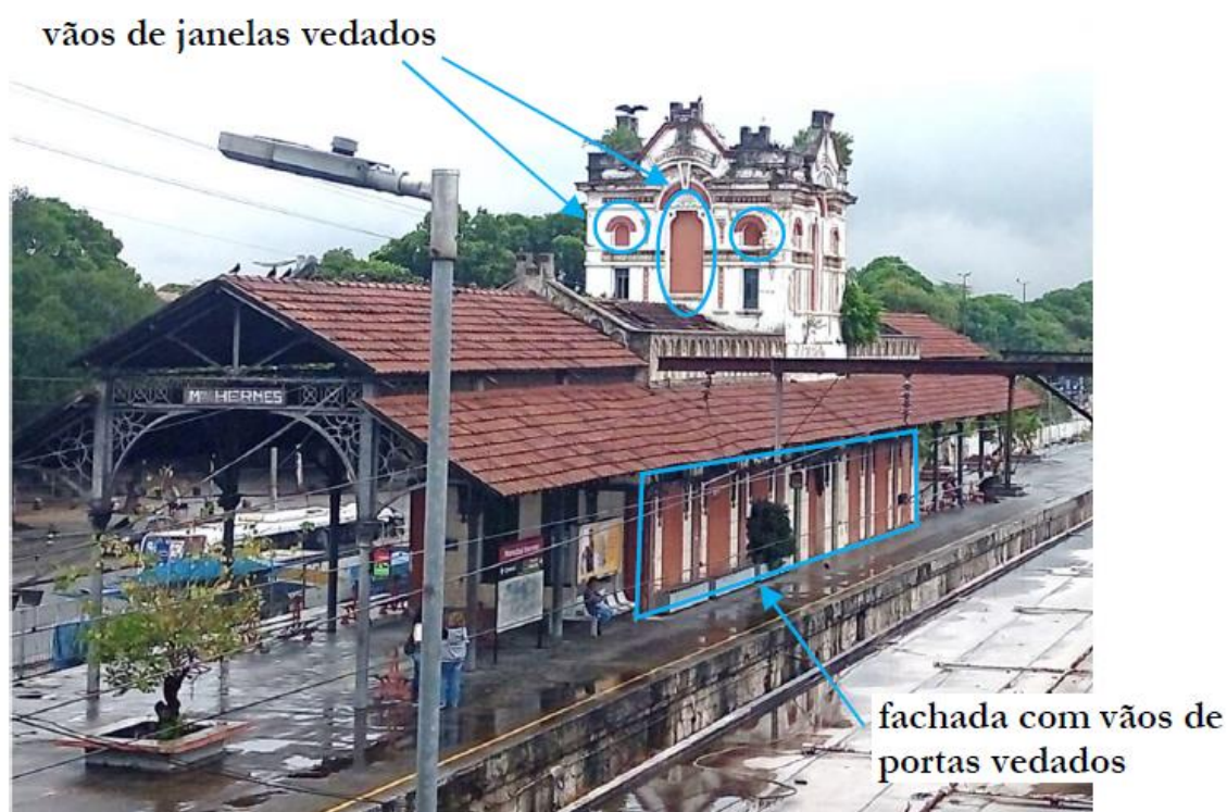
Figura 07 – Vista tomada do acesso da bilheteria, observando-se a fachada voltada para o interior da linha férrea. Nota-se o crescimento de vegetação na cobertura em telhas tipo francesa e no topo do torreão, a vedação dos vãos de porta.
