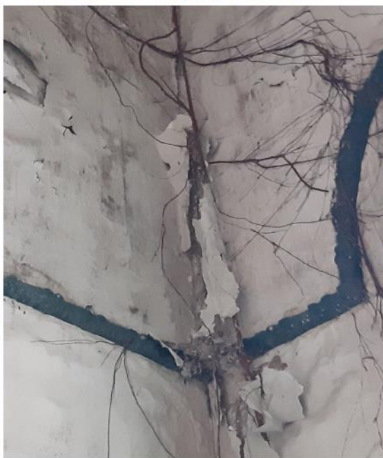
Foto 6 - Infiltração e vegetação na parte interna.
