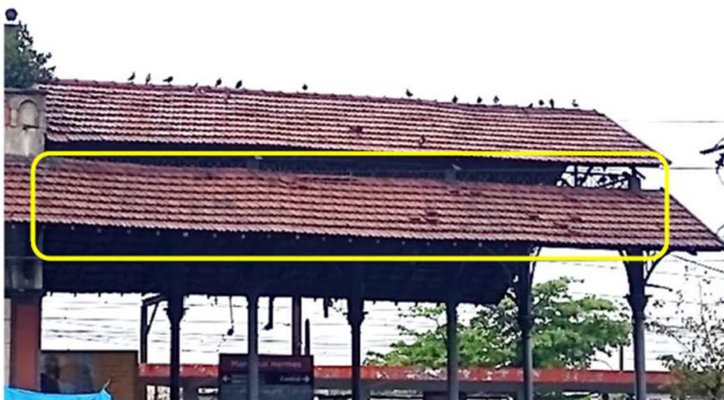
Figura 10 – Observa-se outro trecho da cobertura, na fachada voltada para a Rua João Vicente, com desalinhamento e escorregamento de telhas, em destaque.
