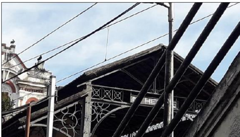
Detalhe de acabamento em madeira, percorrendo a borda do telhado, apresentando desgaste devido à ação do tempo.
