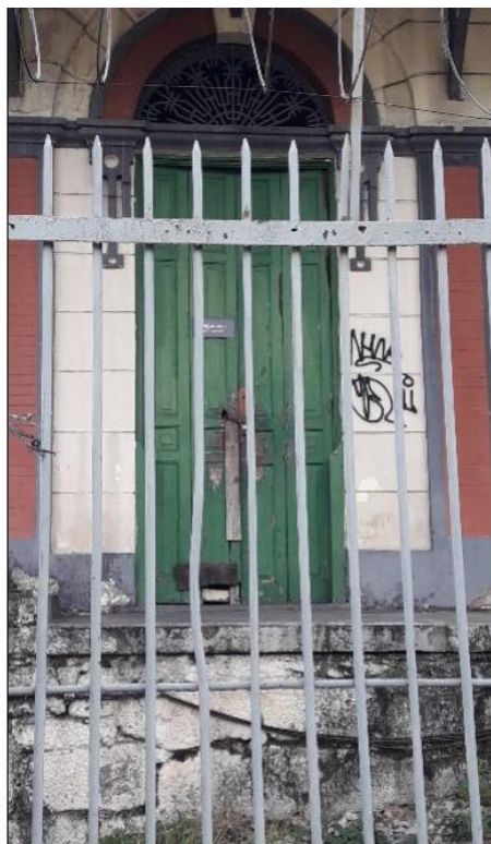
Fachada voltada para a Rua João Vicente: pichações na alvenaria e esquadria em madeira danificada.
