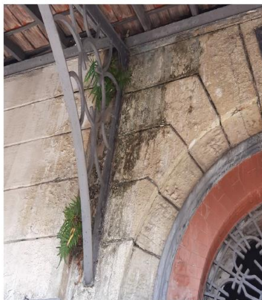
Foto 10 - Vegetação e infiltração.
