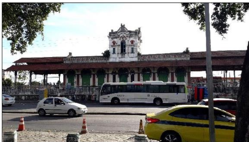
Vista da fachada voltada para a Rua João Vicente, apresentando sujidades, pichações, vidros faltantes nas esquadrias e camada pictórica em deslocamento.
