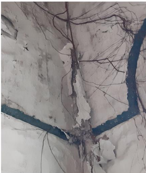
Foto 6 – Infiltração e vegetação na parte interna.
