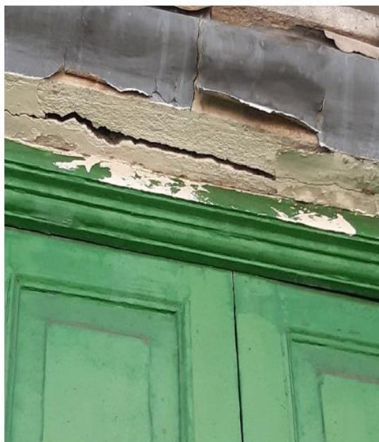
Foto 4 - Rachadura na parte externa.
