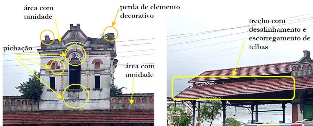
Figuras 08 e 09 – Vista em detalhe do torreão central, e de trecho da cobertura. Observa-se desalinhamento da cobertura, sugerindo algum tipo de deformação na estrutura, escorregamento de telhas, infiltração de água na platibanda, e no topo do torreão central, provocando deterioração do revestimento em argamassa e vegetação crescente. Há ainda alguns trechos de pichação e perda de elementos decorativos.
