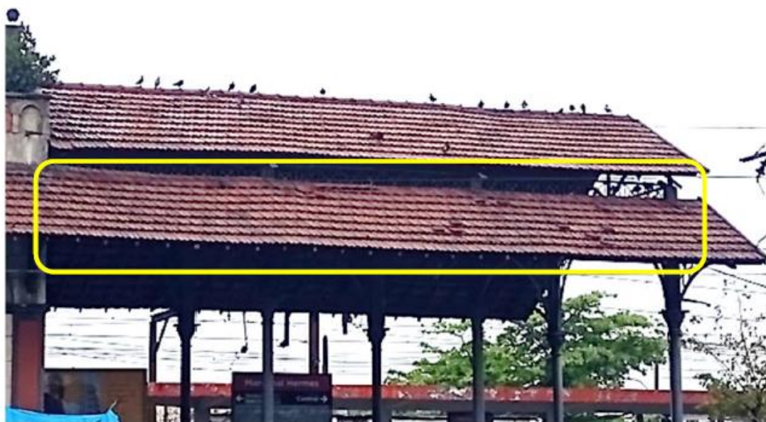
Figura 10 – Observa-se outro trecho da cobertura, na fachada voltada para a Rua João Vicente, com desalinhamento e escorregamento de telhas, em destaque.
