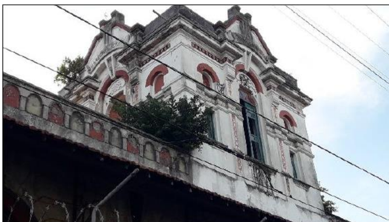
Detalhe de arbustos na porção superior da estação, na fachada voltada para Rua João Vicente.
