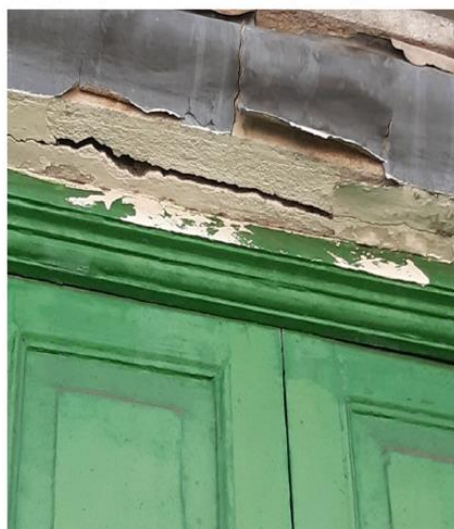
Foto 4 – Rachadura na parte externa.
