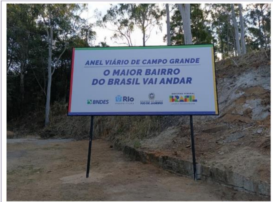
Foto 48 – Placa de identificação – Emboque Sul
