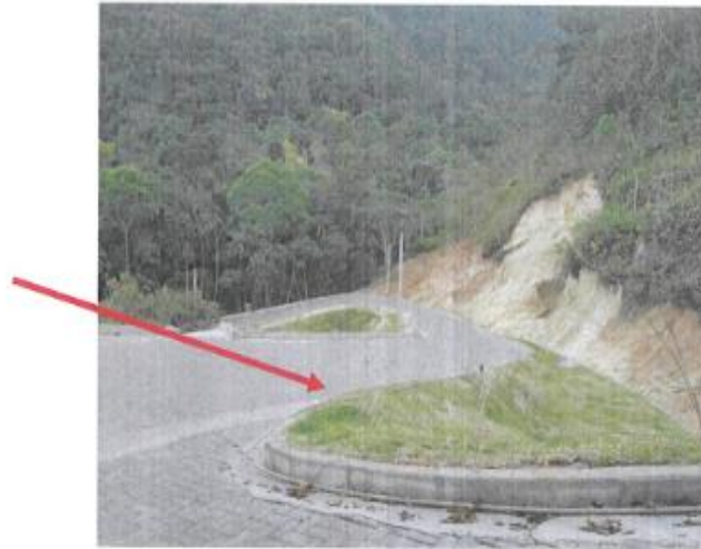
Figura nº 1 – Calçamento implantado em blocos de concreto com destaque para o limite aonde estava implantado por ocasião da autuação e paralisação da obra.
